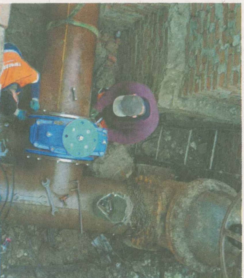
Изношенные водопроводные сети требуют масштабной модернизации
