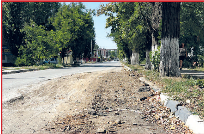
После работ по замене трубы по ул. Майской, 22, которые водоканал вёл 2 месяца назад, асфальтовое покрытие так и не восстановили
