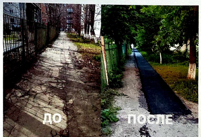
Асфальтовое покрытие дорожки вдоль дома по адресу ул. Севастопольская, 113 Г за счет личных средств Сидорова Г.И.
