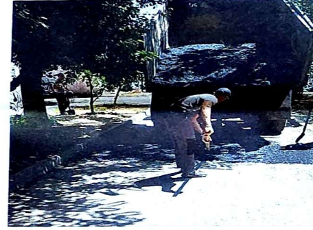
Точечный ремонт дорожного покрытия пер. Осипенко между домами 47 и 47 Б, июнь 2024 г.
