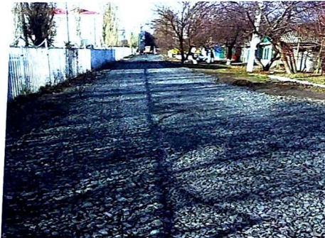
Ощебенение дороги, ул. Крымская, 2016 г. В настоящее время требуется повторный ремонт.
